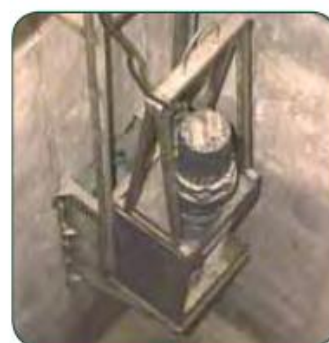
Channel Monster, установленный в насосной станции с направляющей рамой.
