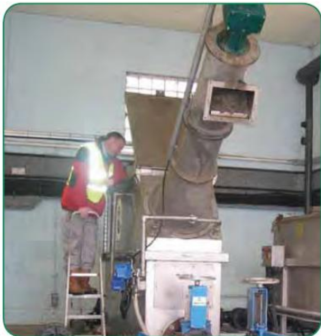
Honey Monster на очистных сооружениях в Великобритании.
